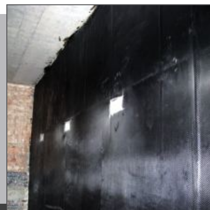
Wzmocnienie ściany żelbetowej laminatem z tkaniny węglowej dwukierunkowej FRP strengthening of concrete wall
