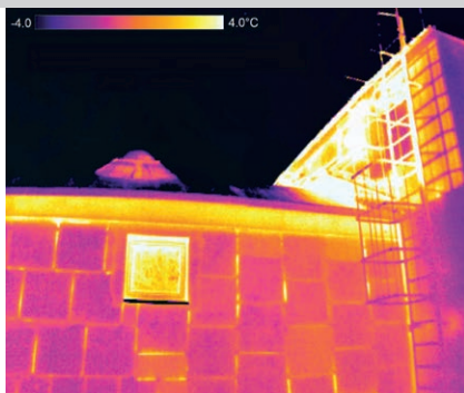
FOT. 2. Zdjęcie termowizyjne ściany budynku herpetarium; widoczne połączenia oraz panel celowo rozszczelniony podczas montażu
